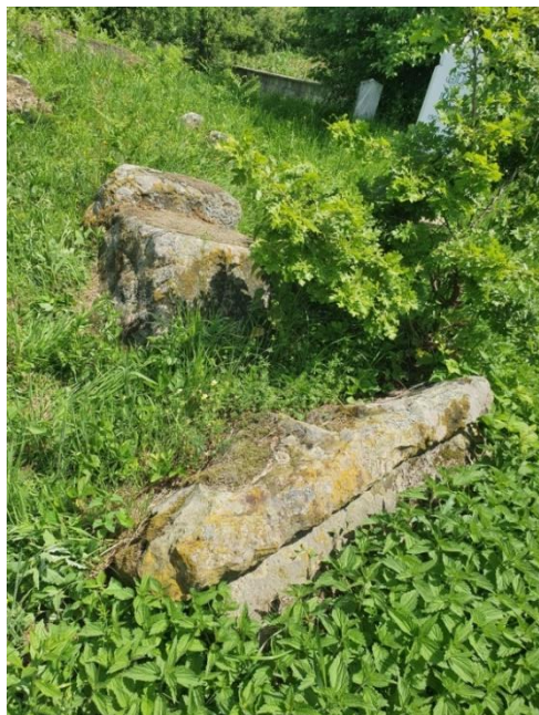
Slika br. 2 Stećci prije sanacije
