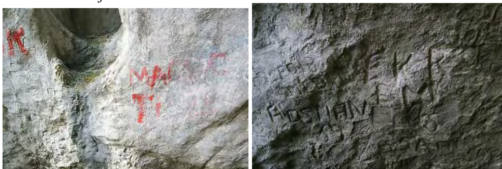
Sl. 9. i 10. Oštećenja ulaznog dijela u pećinu
