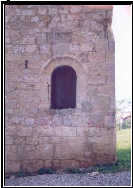
Slika 3. Ulazna vrata, natpis i oštećenja od gelera na gradačačkoj sahat-kuli
